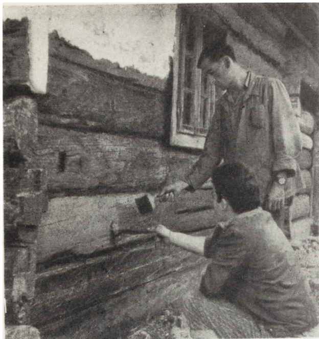
2. Sanok, Muzeum Budownictwa Ludowego, impregnacja Xylamitem Popularnym konstrukcji chałupy z Dąbrówki (fot. W. Szulec)
