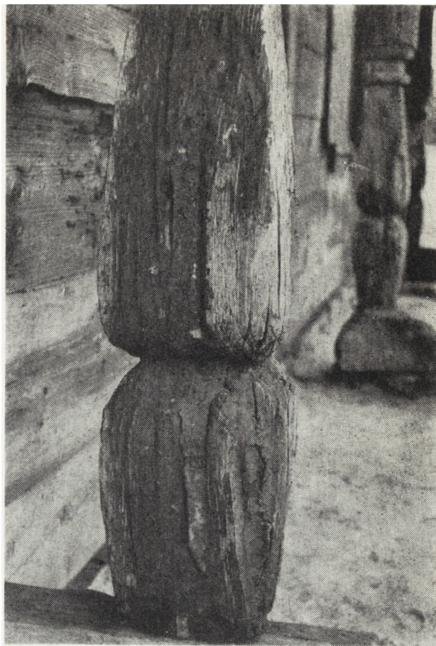
3. Niewłaściwie dobrana masa uzupełniająca pęka i odstaje od drewna (fot. Z. Sroczyński)
