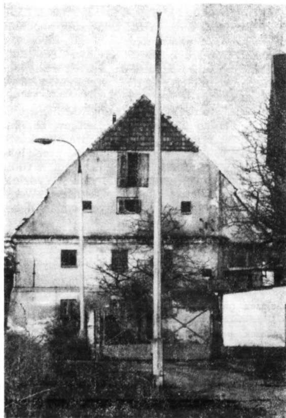
Zabytkowy spichlerz na skraju osuwiska. Widoczna rysa pęknięcia murów.
