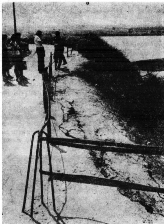
Zniszczenia skarpy przed ich zabezpieczeniem w sąsiedztwie Domu Turysty
