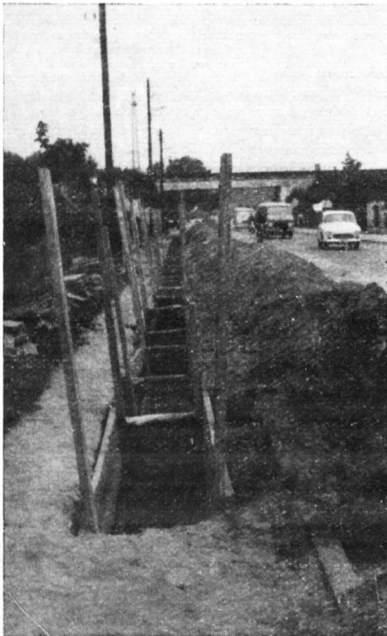
15. IX. 1966 r. pierwsze wykopy wykonane na ul. Kolejowej dla wodociągów w Radziwiu, których budowa jest podstawowym czynem społecznym w pionie gospodarki komunalnej Płocka.
